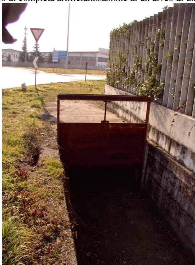
Esempio di imbocco di una copertura della roggia, munita di paratia
