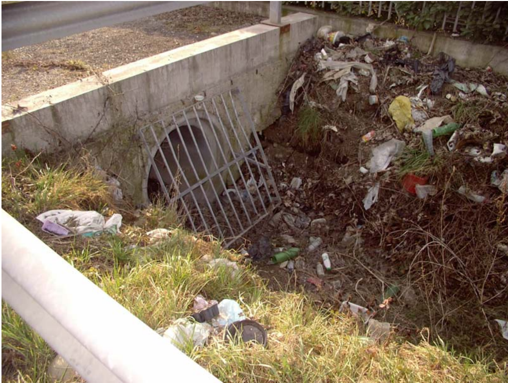
Esempio di ingresso di una tombinatura munito di griglia. E' visibile il degrado generale in cui versano le rogge in vicinanza a strade di transito e come la pulizia periodica avvenga senza la rimozione dei rifiuti accumulatisi.
